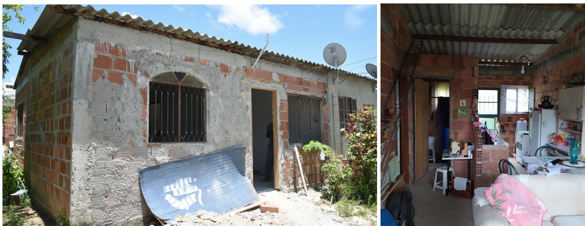
Figuras 6 e 7: Unidade localizada no Assentamento Camburi, antes do programa de melhorias.
